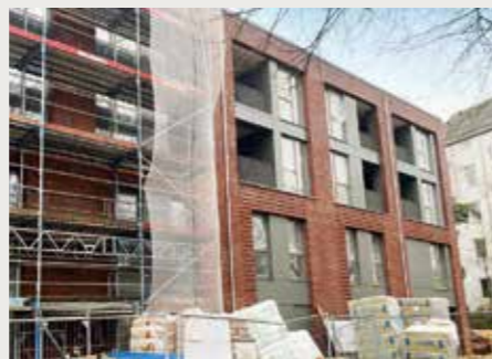
Blick in die Elisabeth-Will-Straße 2 und 2a/b in den Kolbenhöfen II während des Gerüstabbaus Anfang Februar 2024
